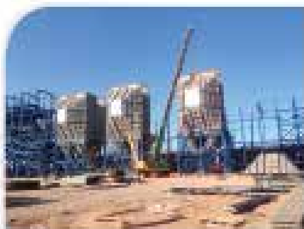
طراحی، ساخت و نصب اکتیو فیلتر های کارخانه کوره سازی مسکن
